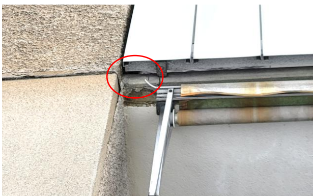
Bild 2, Mindre skada i framkant, hus 5 baksida vån 3.
