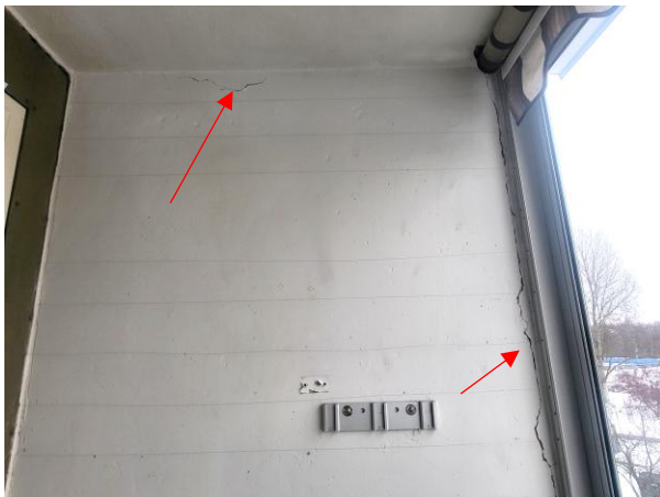
Bild 1, Sprickor i skärmnos och i takvinkel. Hus 5, framsida våning 2.
